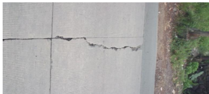
Gambar 6. Kerusakan Jalan dengan Belahan
