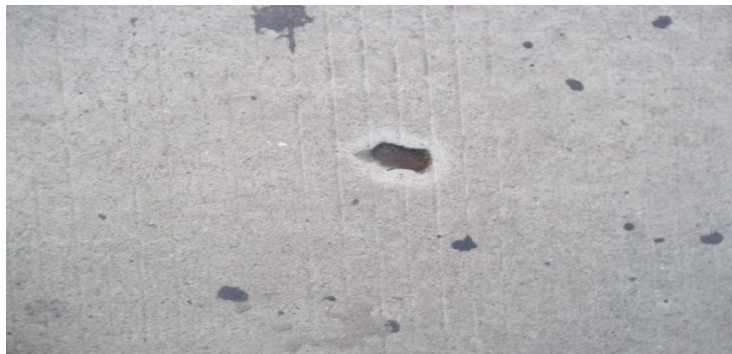
Gambar 5. Kerusakan Jalan lubang
