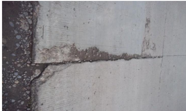
Gambar 4. Kerusakan Jalan Lepas
